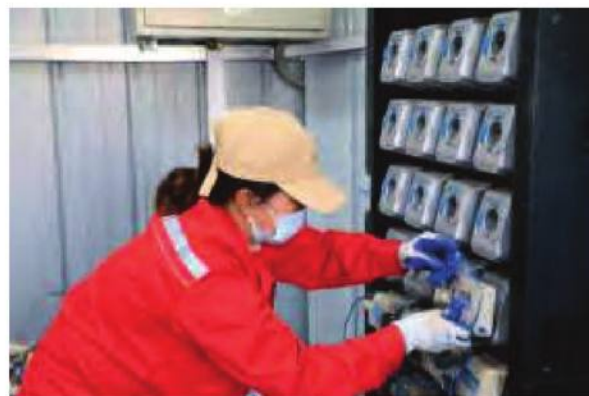
▲ Рис. 2. Считывание материала и зарядка аккумуляторов в стойке с блоков IGU-16HR-IES.
