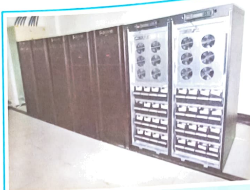
Оборудование вычислительного центра
